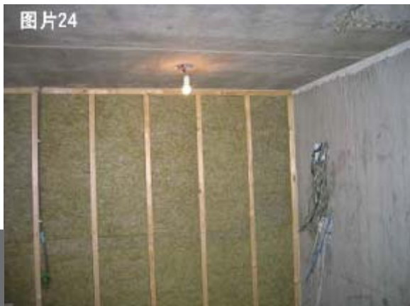
图片二十四 以混凝土/砖石墙做框架为保温材料的安装和内置墙的建成提供了条件。使用棉絮或喷洒型保温材料均可。加拿大国家林业研究院 (Forintek Canada Corp) 提供
