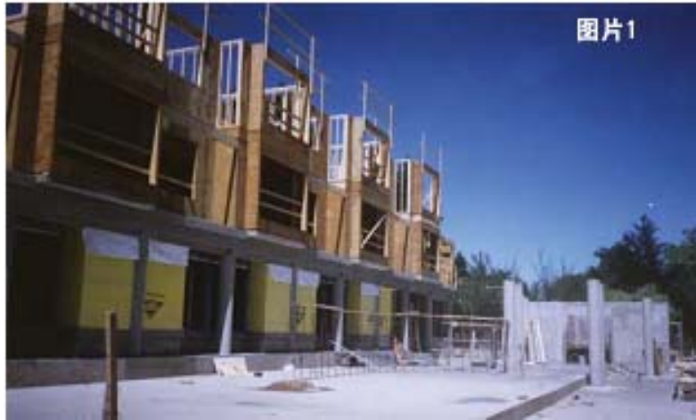
图片一 建筑中将混凝土、砖石与木材结合使用的方法很多。图中该建筑上层为木制框架，下层是混凝土底层。尼勒斯·丹尼斯克斯和多尔·亚当斯建筑师事务所 (Neale Staniszkis Doll Adams Architects) 提供。
